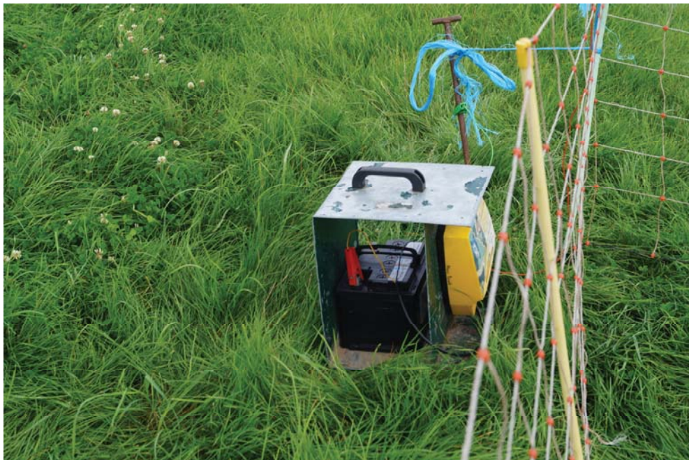
Abbildung 3: Geerdetes Stromgerät mit Witterungsschutz
